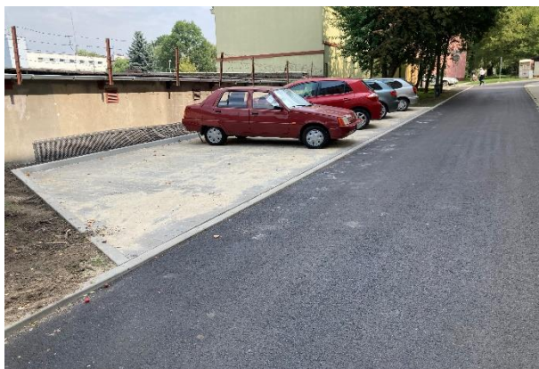
Zdjęcie przedstawia remont drogi, parkingu i chodników w Skawinie przy ul. Słonecznej.
